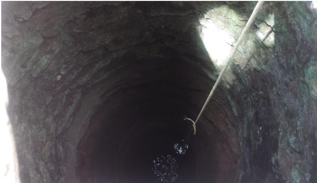
Fotografía 20: Profundidad de la noria, aproximadamente 12 metros
