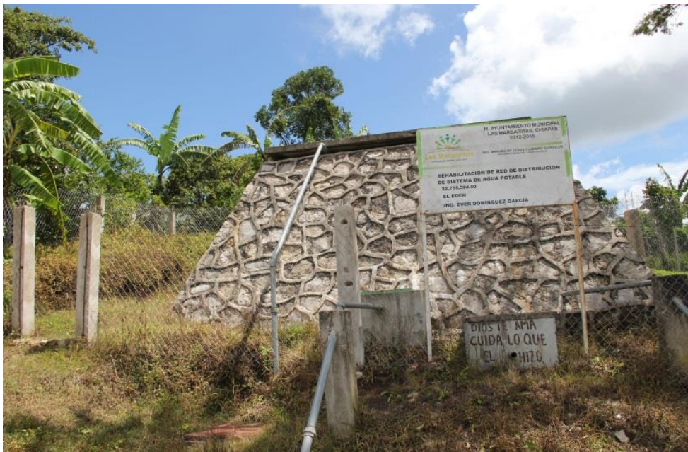
Fotografías 41 y 42: Información sobre la inversión y uno de los tanques de almacenamiento del SAE A4
