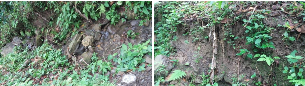
Fotografías 91, 92 y 93: Fuente 2 del SAE B5, banco del cauce con azolvamiento y erosión
