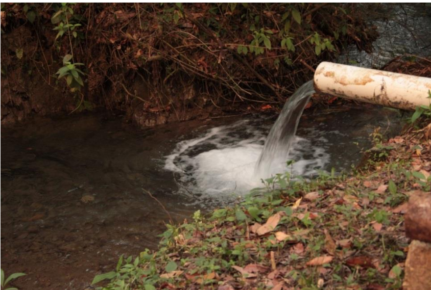
Fotografía 52: Salida de excesos del tanque de captación del SAE B2, se observa erosión al fondo
