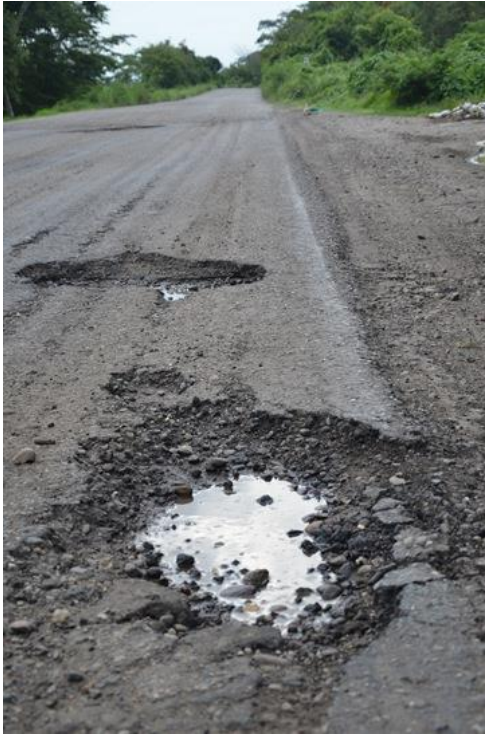
Fotografía 23. Deterioro de las principales vías de comunicación
